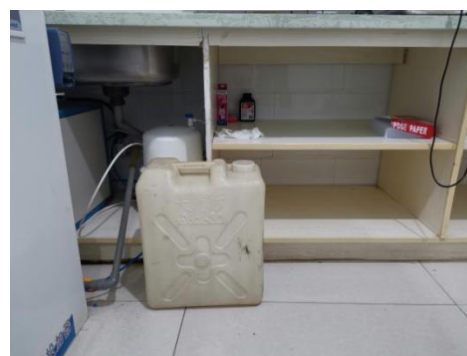
化验废水收集装置
